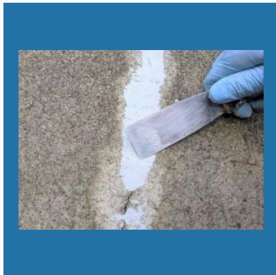
BULWARK FILL A CRACK
